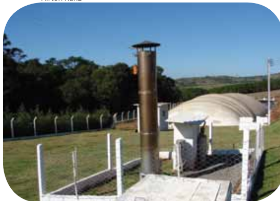
Biodigestor e Flare (Sistema padrão para obtenção de certificações de carbono).
