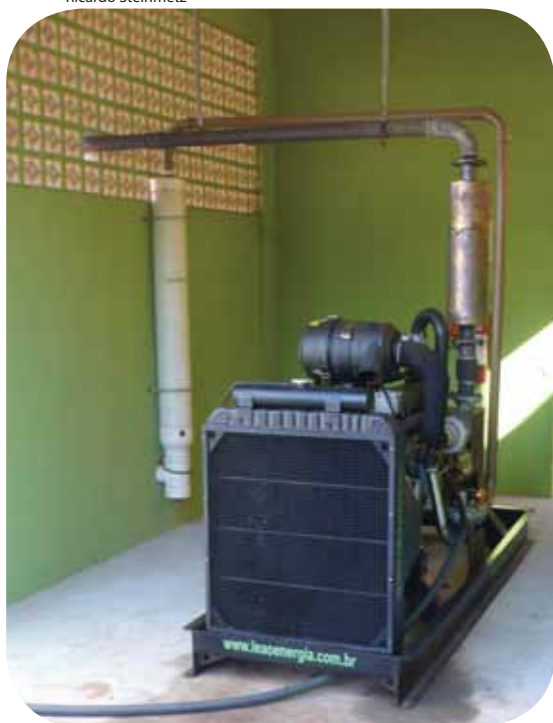
Gerador de energia elétrica movido a biogás.
